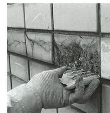
【写真8】タイル打ち込みも要注意 タイル打ち込み工法も、背面のコンクリートに充填不良があると剥落の原因になる
