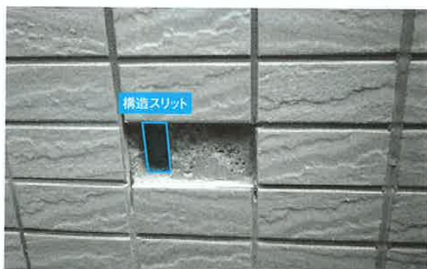
【写真6】構造スリットをまたぐとトラブルのもと 構造スリットをまたいでタイルを張ると、タイルが下地の挙動に追従できず、構造スリットに沿って剥落が起こりやすい
