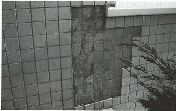
【写真3】タイル陶片の剥落 下地のコンクリートにひび割れが生じたことが原因で、周囲のタイル陶片が剥落した
