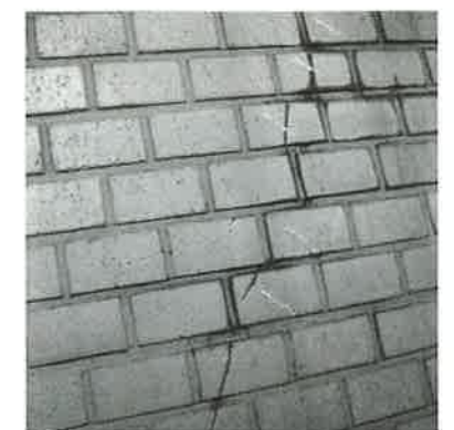
【写真9】躯体ひび割れから連鎖反応 躯体コンクリートにひび割れが生じると、ひび割れをまたぐタイルが割れたり浮いたりする
