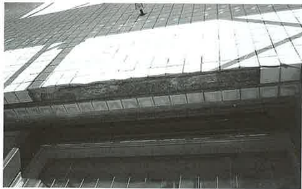
【写真5】上げ裏部分にはタイルを張らない 上げ裏部分はタイルの施工が難しいうえ、浮きが生じて確認しにくい。上げ裏部分は塗装仕上げとすることが望ましい
