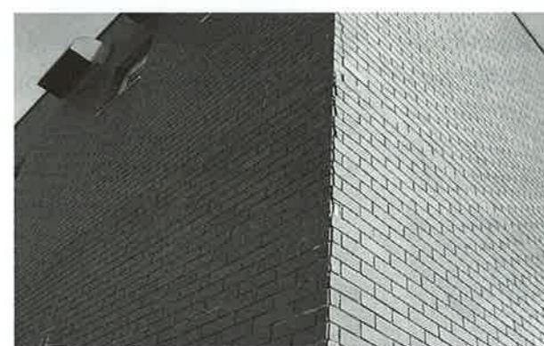
【写真10】伸縮調整目地を設けていない 外壁の出隅部で鉛直方向に長いひび割れが生じた。壁面に日射が当たり、タイル仕上げ層が膨張したことが原因。伸縮目地は必須だ
