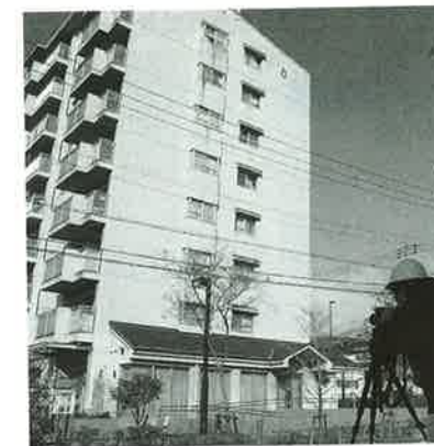
〔写真2〕赤外線法による外壁調査 ある程度の距離をとって、地上からタイル熱画像を撮影するので仮設足場は不要だ
