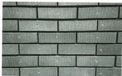
〔写真5〕タイルのアンカーピンニング 個々のタイルをアンカーピンで固定。ダイヤモンドビットで削孔する
