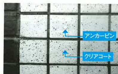
〔写真6〕クリア塗材による剥落防止工法 引張力の大きいクリア塗材と、アンカーピンを併用することで剥落を防止する(写真:アイカ工業)
