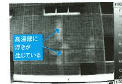
〔写真3〕サーモカメラで撮った熱画像の例 熱画像を判読してタイル浮きを抽出する。白っぽい部分が高温部で、浮きが生じた箇所だ
